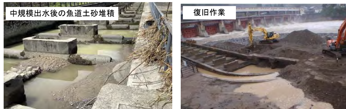
図 1.1.2 中規模出水後の魚道土砂堆積と撤去状況
