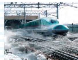
新幹線散水消雪設備の熱源を高効率化
